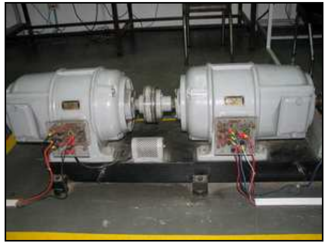
FIG. 112 Conjunto Motor – Generador
